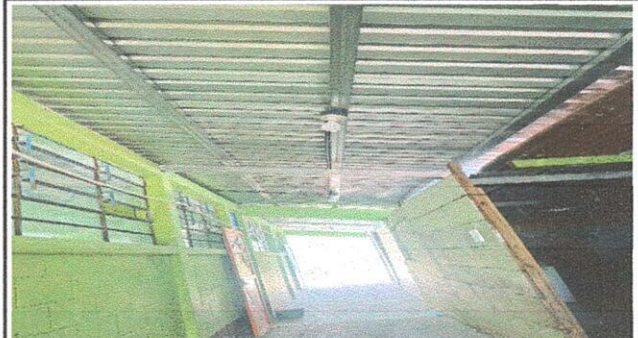
Foto 4: Pasillo del establecimiento con alumbrado eléctrico nuevo
